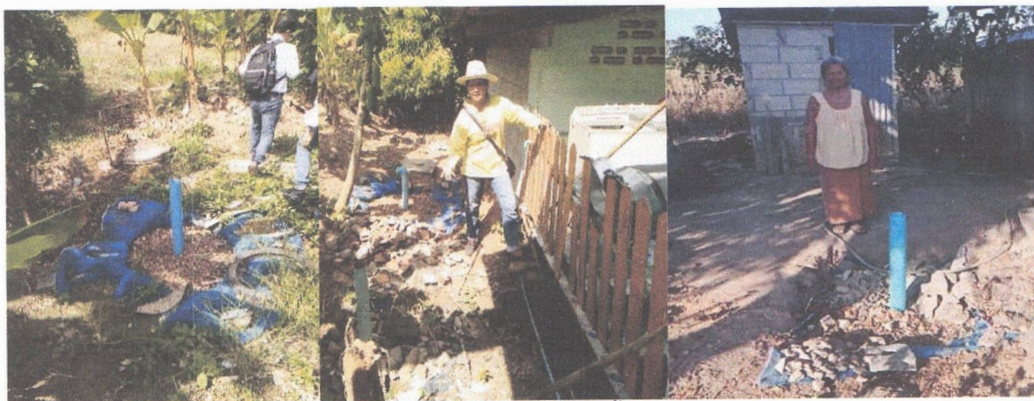
ธนาคารน้ำใต้ดินระบบบ่อปิดเพื่อเก็บน้ำเสียจากบ้านเรือน
